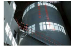
河南中原黄金机械厂制作施工的“中国黄金第一槽”（浸出槽直径12米，高13米）
