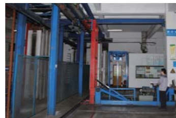
辐照加工车间
