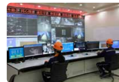
贵州锦丰公司选冶工艺流程PLC控制系统
