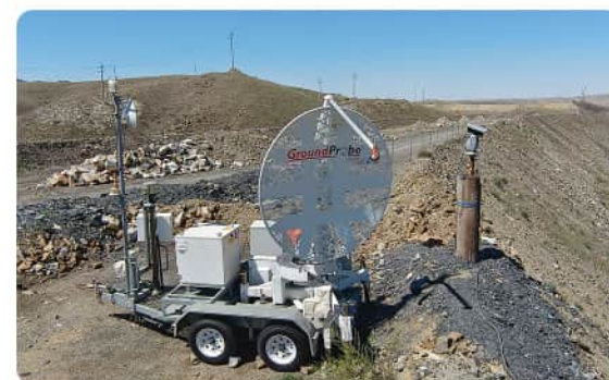
内蒙古太平公司加装全景激光云台的边坡雷达实现24小时在线监测
