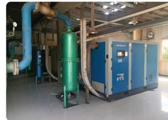
河北东梁公司低压变频螺杆空压机
