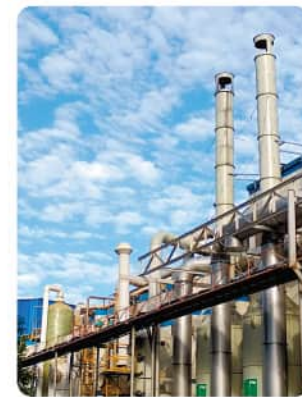
江西三和公司氧化槽气体收集喷淋塔
