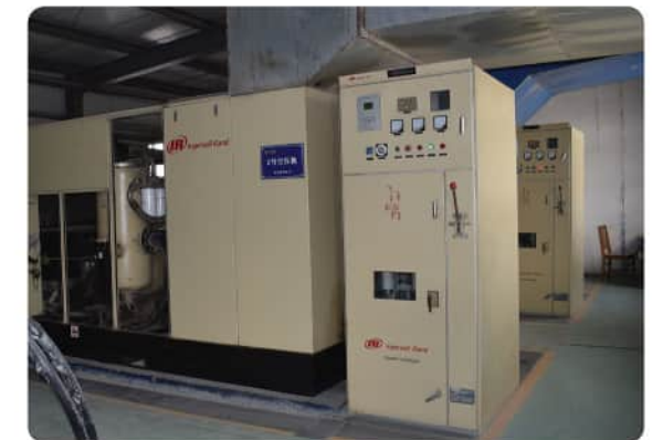
山东鑫泰公司节能空压机
