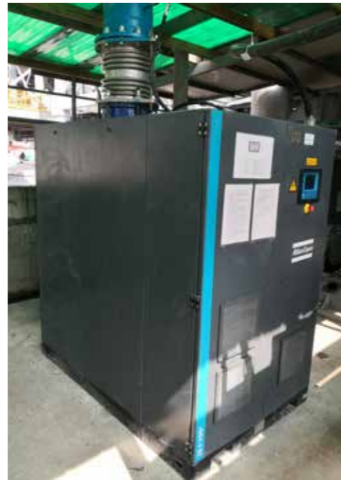
贵州锦丰公司磁悬浮风机
