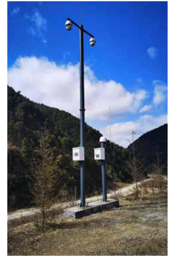
天水李子公司尾矿库在线监测系统
